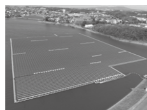
豊明市水上メガソーラー発電所（若王子池）
